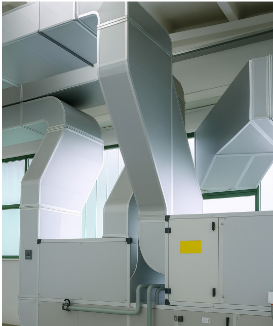
شکل ۱: یک سیستم کانال کشی نزدیک هواساز
